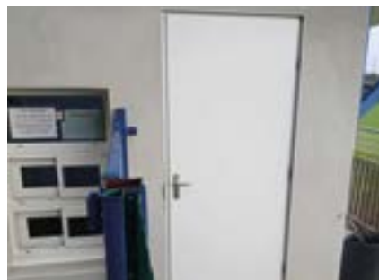
5 Changement porte entrée buvette foot suite au vandalisme
